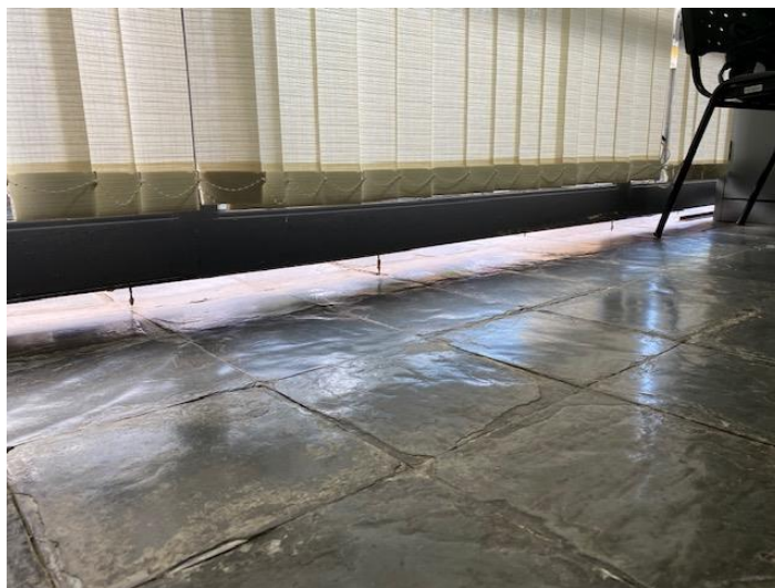
abatimento do piso
