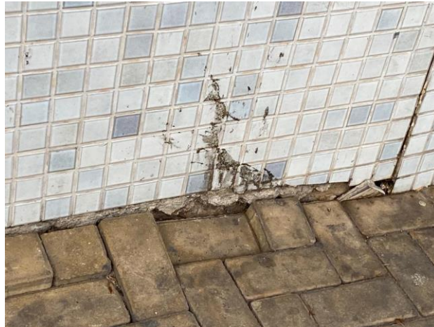
abatimento de piso
