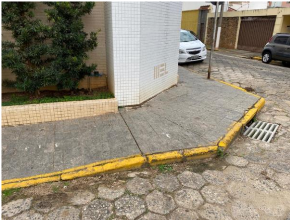
prédio vizinho: fenda entre calçada e muro
