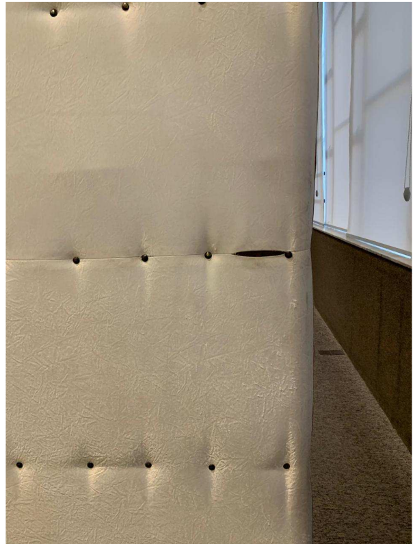
Fig. 02: Revestimento do pilar rasgado
