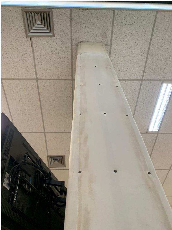
Fig. 01: Manchas no revestimento do pilar
