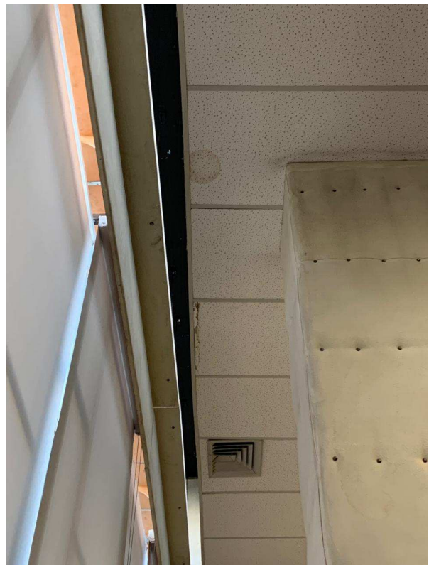
Fig. 04: Acabamentos pilar, forro e cortineiro deteriorados
