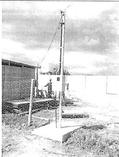
Instalações provisórias de energia elétrica
