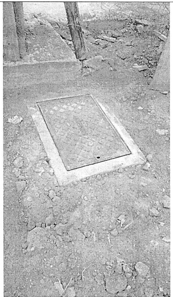
Instalações de Combate a Incêndio – Hidrante de recalque
