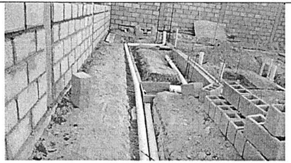
Instalações Hidráulicas e Sanitárias - Tubo de PVC esgoto predial
