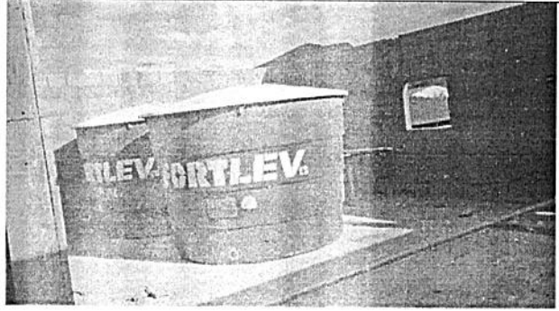
Instalações de combate à incêndio
