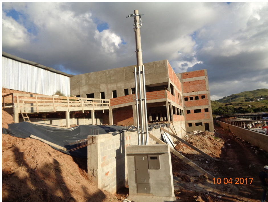
Mureta, poste e caixa - entrada de energia
