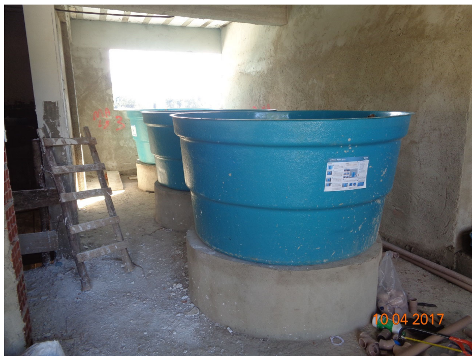
Caixas d' água para o sistema de prevenção e combate a incêndio
