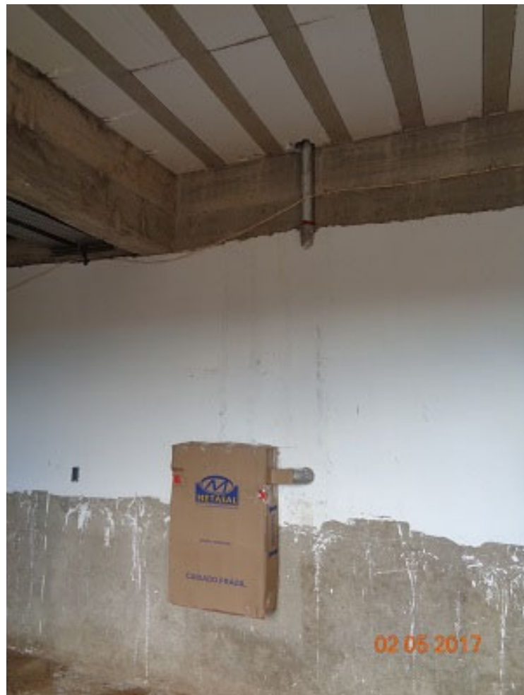
Tubulação e caixa para hidrante - inst. de prevenção e combate a incêndio
