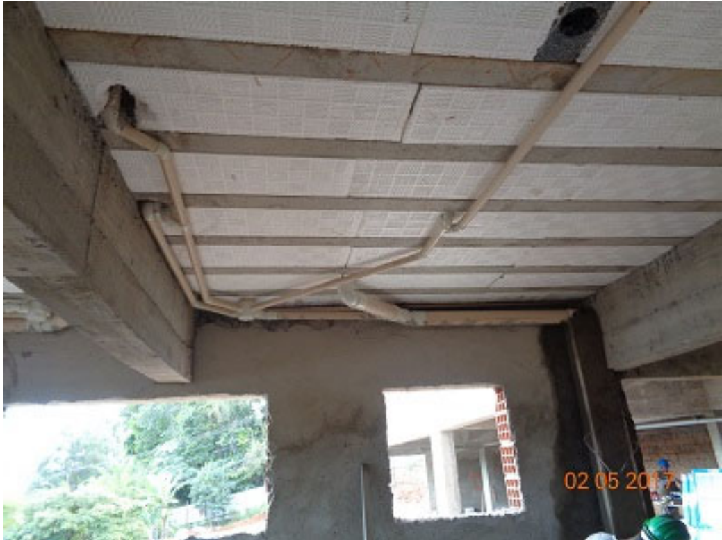
Instalações de esgoto
