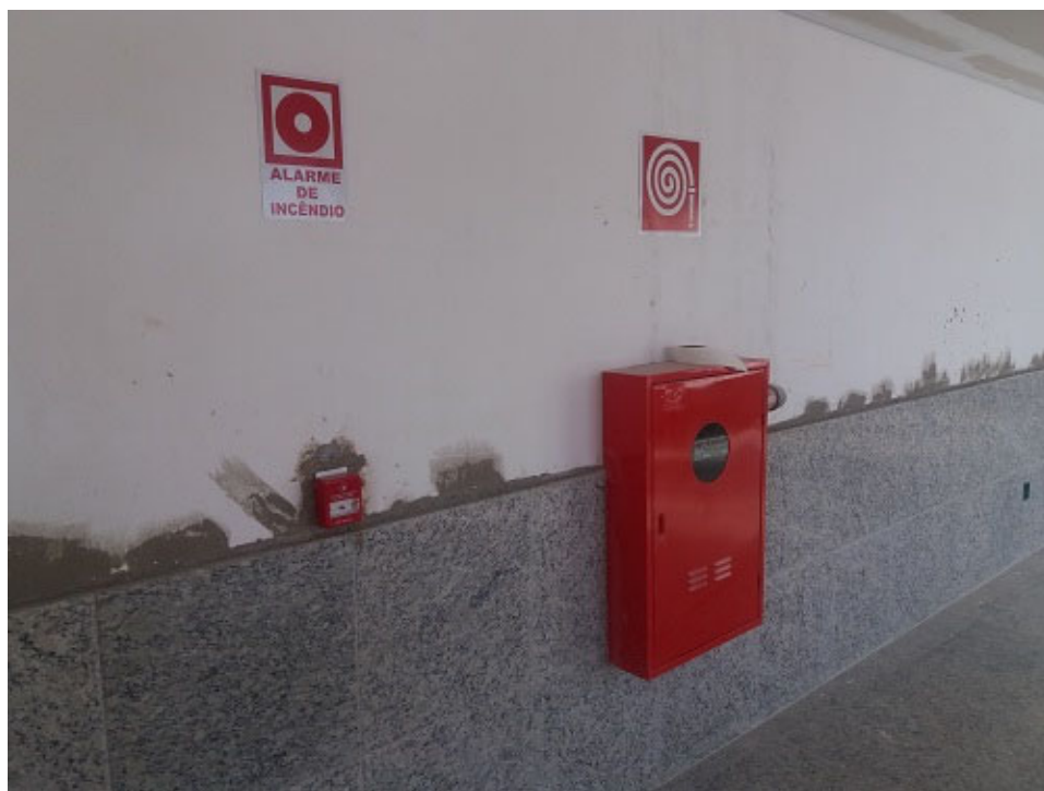
Instalações de prevenção e combate a incêndio
