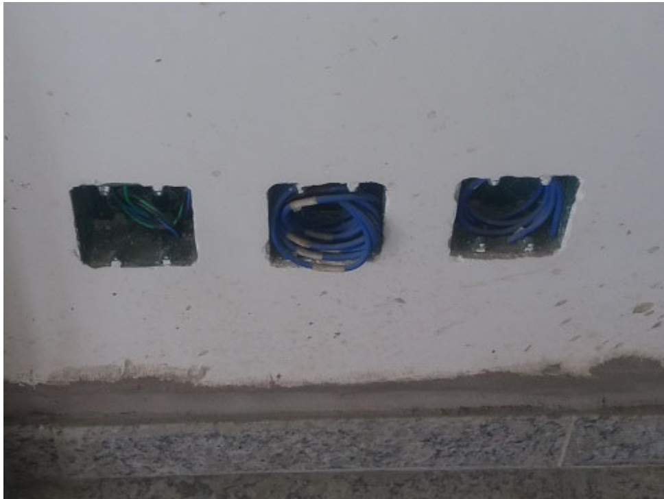
Instalações elétricas e de rede de lógica
