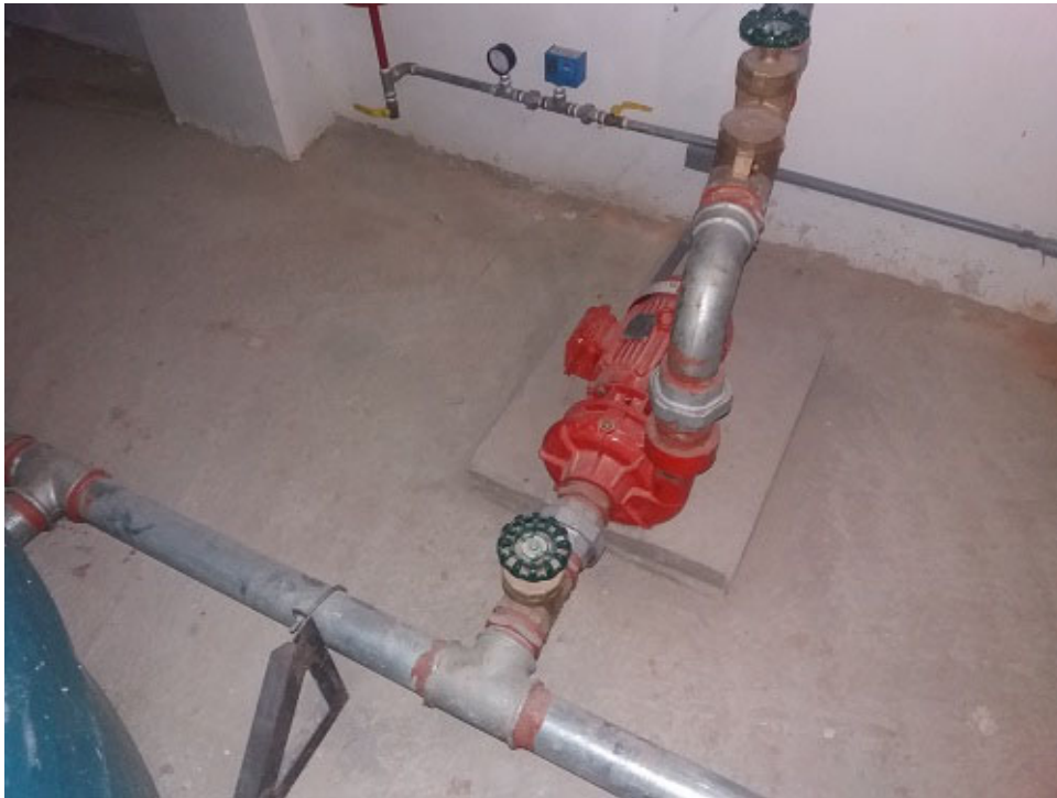
Instalações de prevenção e combate a incêndio
