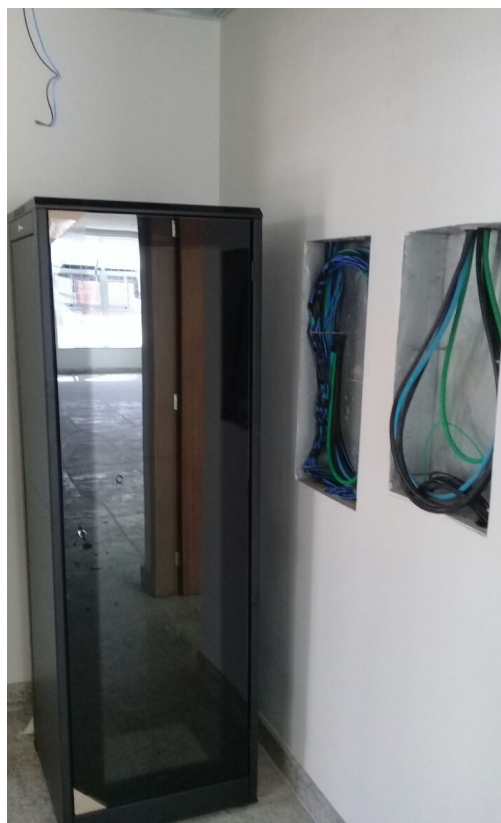
Elétrica e SPDA, cabeamento estruturado
