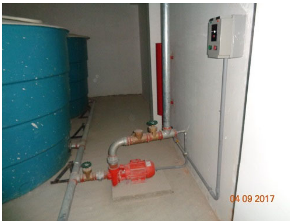
Instalações de combate a incêndio
