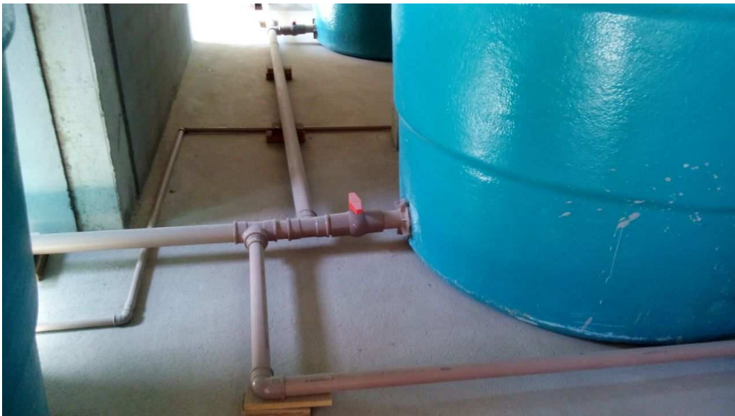
INSTALAÇÕES HIDRÁULICAS DATA: JULHO/2016
