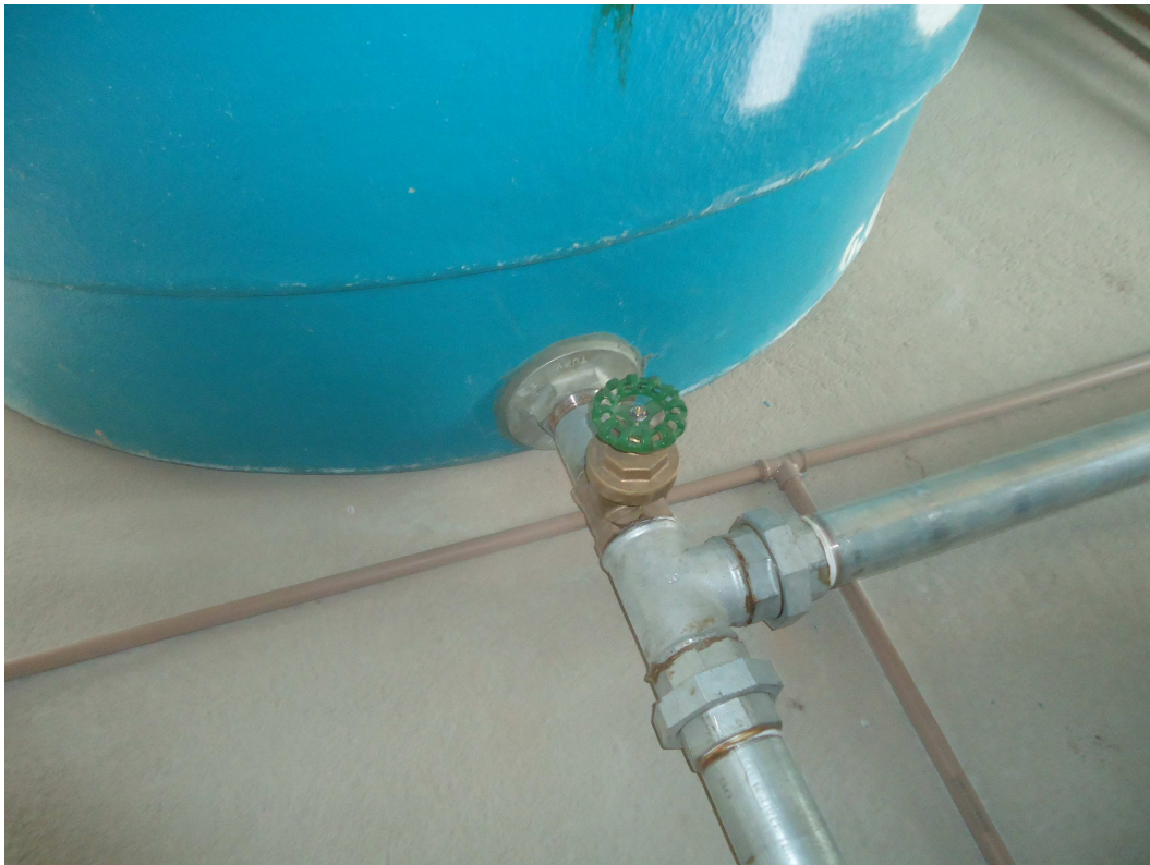
INSTALAÇÕES DE COMBATE A INCÊNDIO DATA: JULHO/2016
