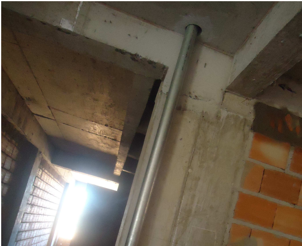
INSTALAÇÕES DE COMBATE A INCÊNDIO DATA: JULHO/2016
