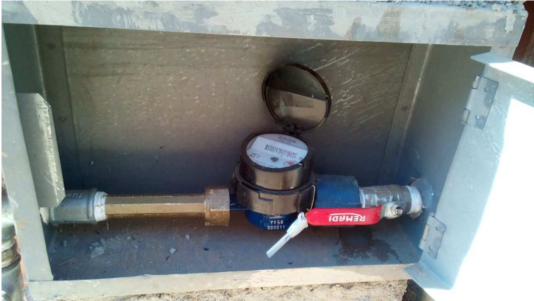
INSTALAÇÕES HIDRÁULICAS - HIDRÔMETRO DATA: JULHO/2016
