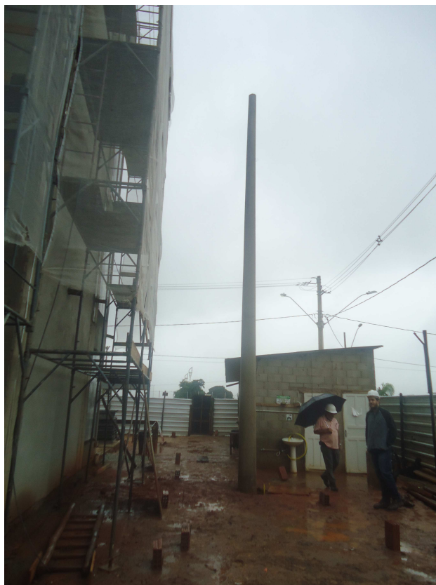
POSTE - SUBESTAÇÃO DATA: DEZEMBRO/2016
