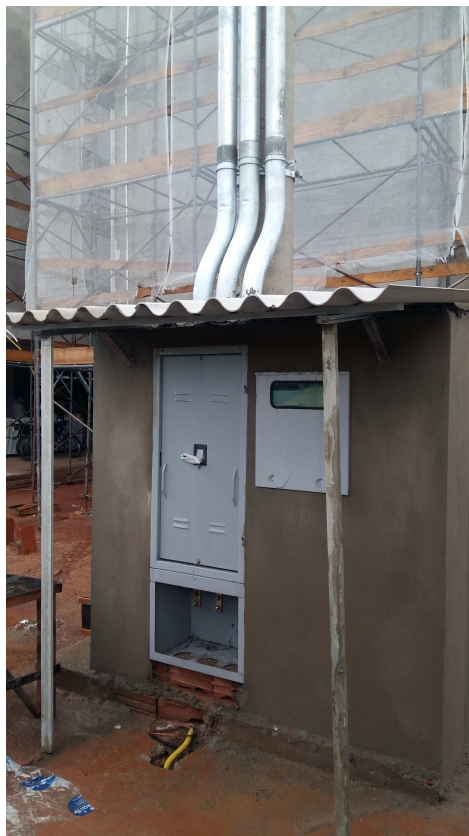
SUBESTAÇÃO DATA: JANEIRO/2017
