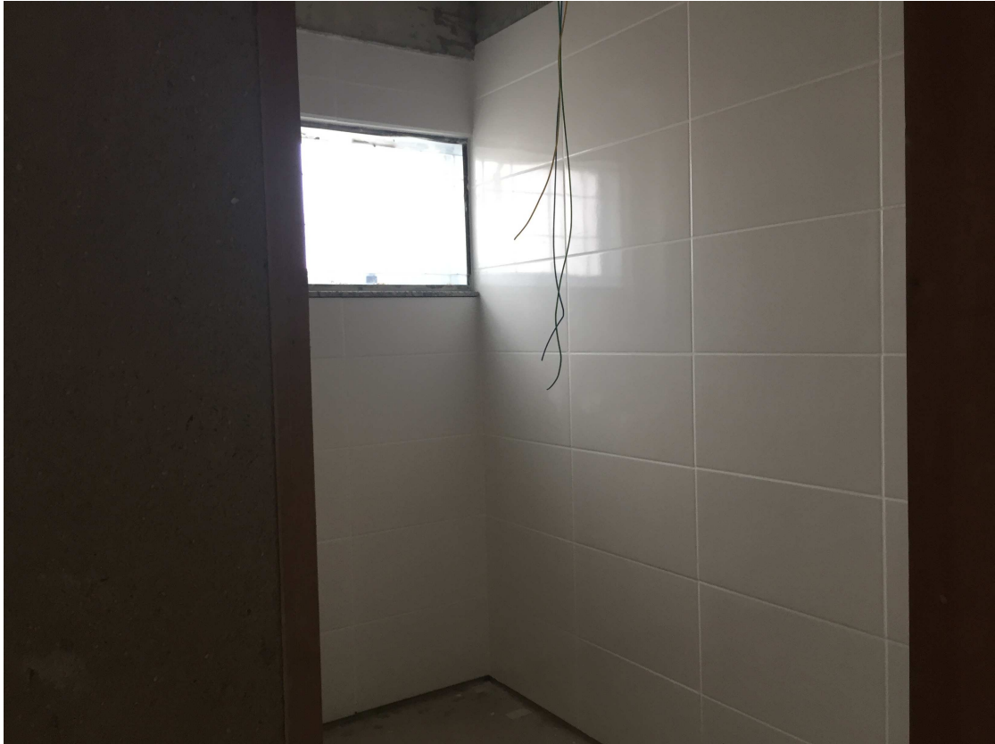
ESQUADRIA E CERÂMICA (AZULEJO) DATA: JANEIRO/2017
