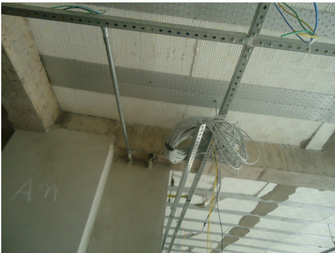
CABO UTP E CABO COBRE DATA: JANEIRO/2017
