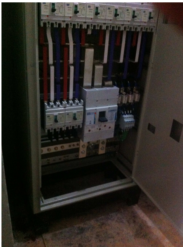
QGBT, DISJUNTORES DATA: FEVEREIRO/2017
