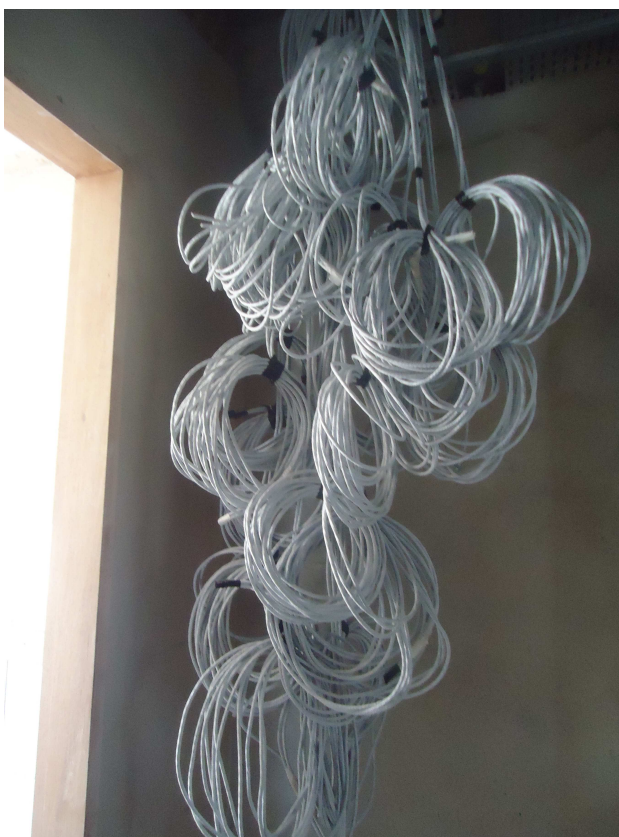
CABOS UTP (ONDE SERÃO CONECTADOS AO RACK) DATA: FEVEREIRO/2017
