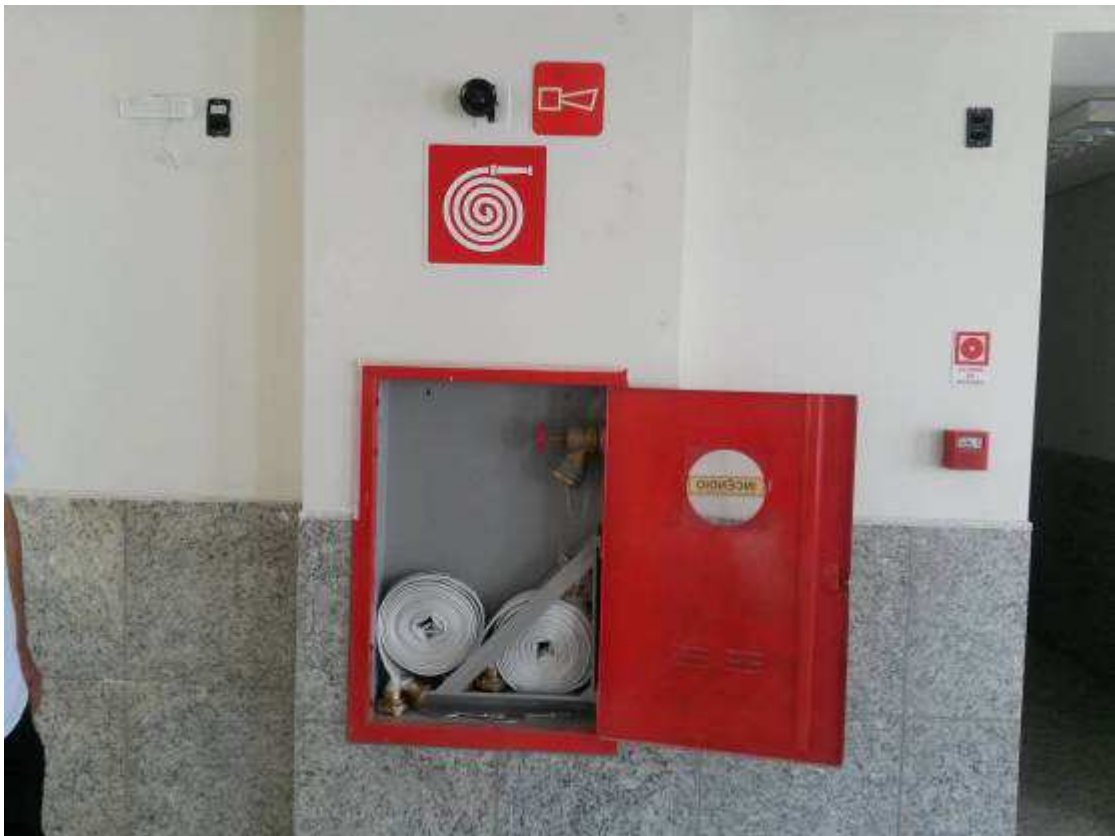
INSTALAÇÕES DE COMBATE A INCÊNDIO DATA: AGOSTO/2017
