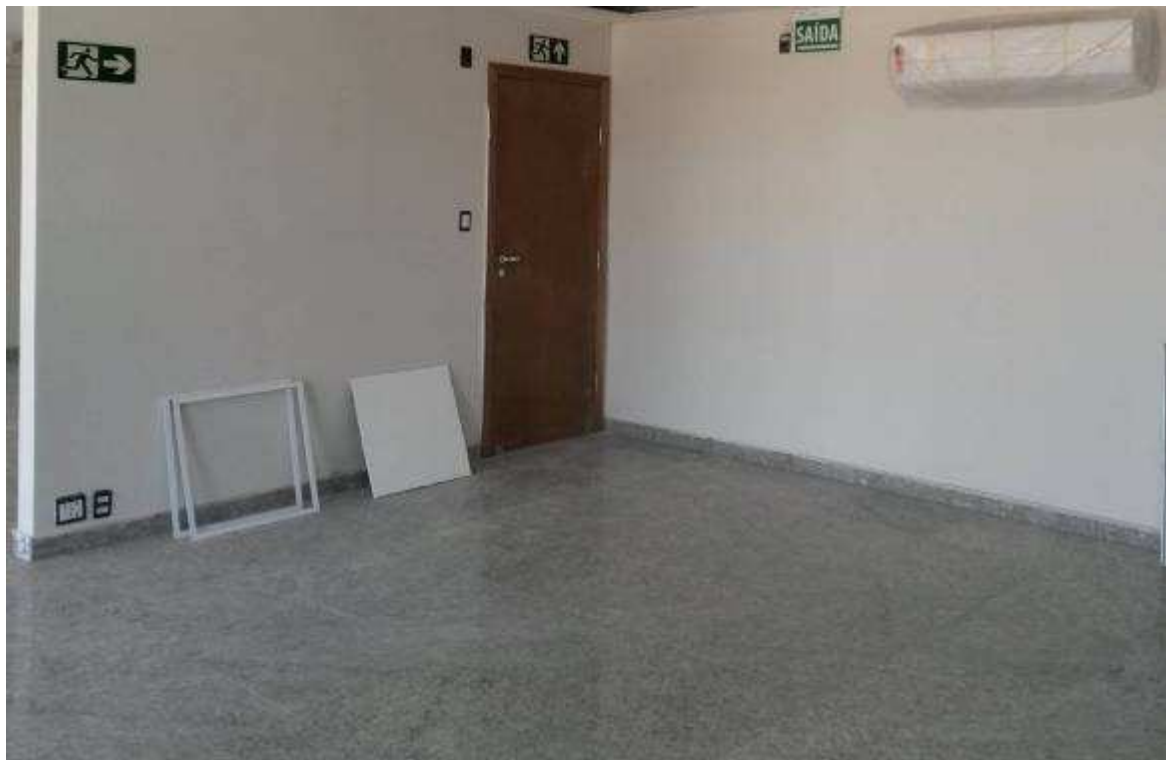
CONECTORES RJ, TOMADAS, AR CONDICIONADO, INSTALAÇÕES DE COMBATE A INCÊNDIO DATA: AGOSTO/2017
