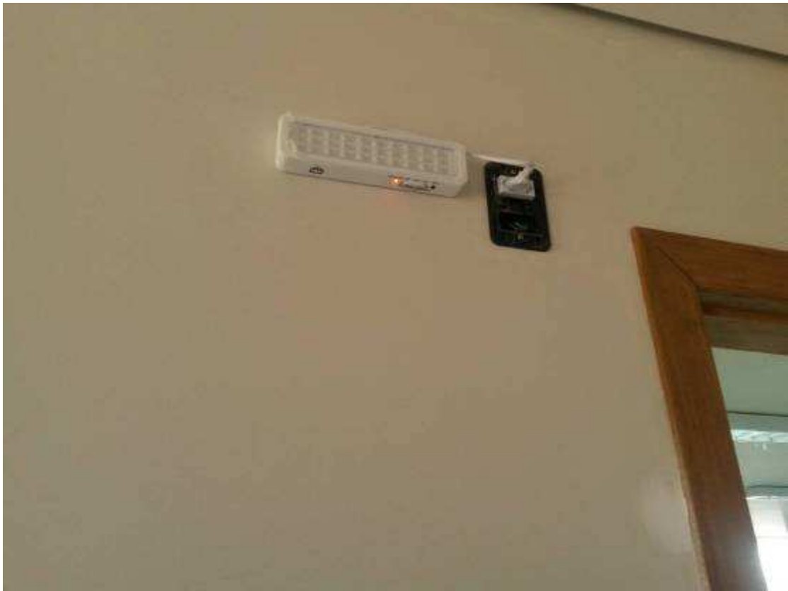
LUMINÁRIA DE EMERGÊNCIA DATA: AGOSTO/2017
