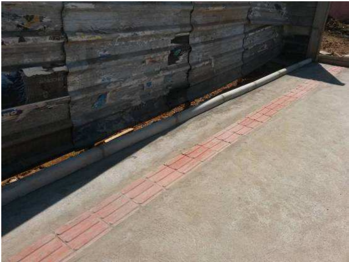
PASSEIO EXTERNO, PISO PODOTÁTIL DATA: AGOSTO/2017
