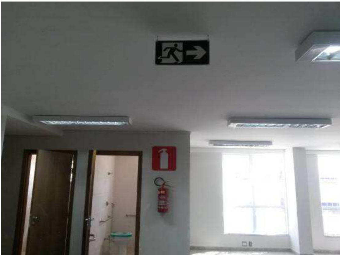
INSTALAÇÕES DE COMBATE A INCÊNDIO DATA: AGOSTO/2017
