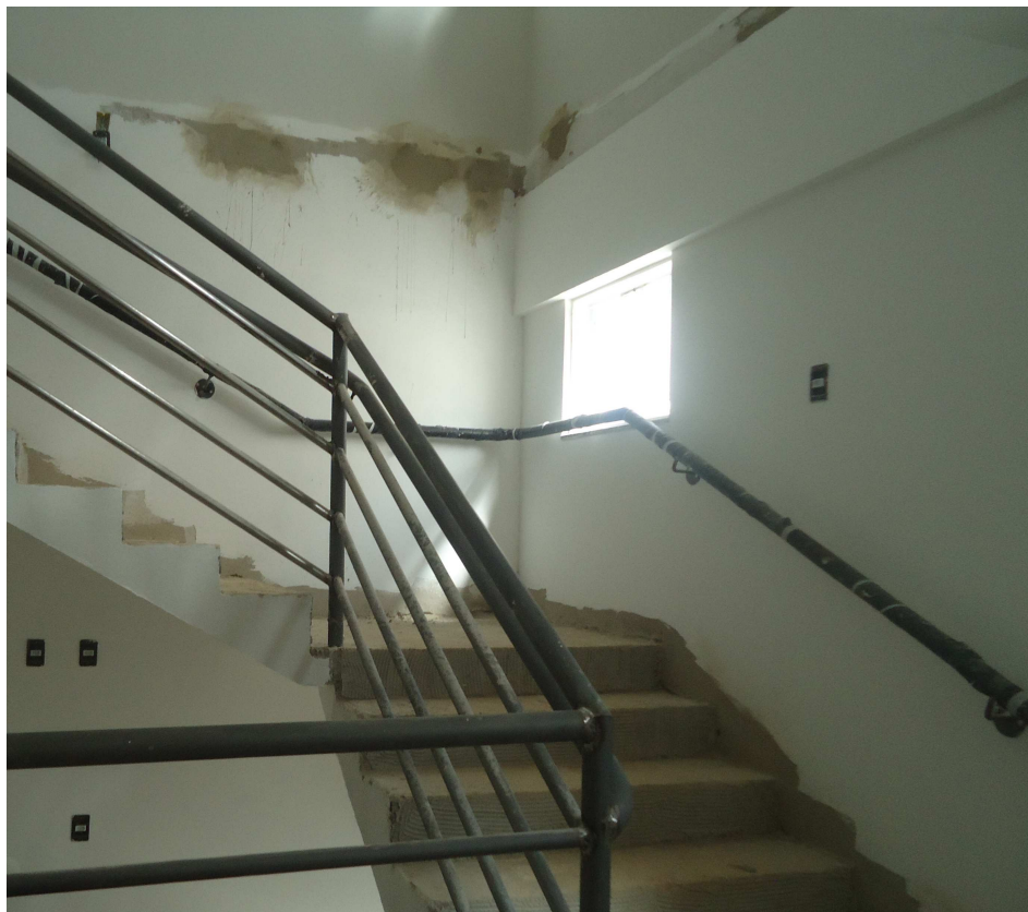
CORRIMÃO, GUARDA-CORPO DATA: JUNHO/2017
