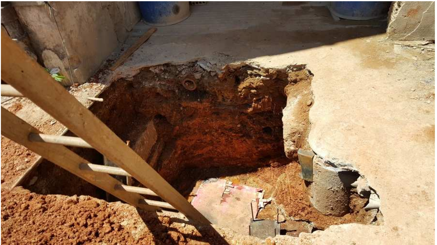
02 - Escavação manual de blocos para fundação da passarela de interligação dos edifícios.
